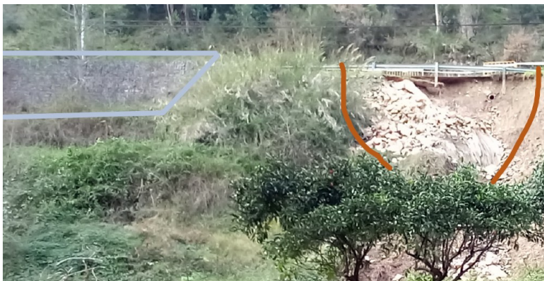
Lado esquerdo muros de gabião existentes. Lado direito, derrocada 2025.
