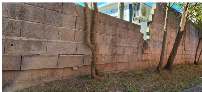
Muro de blocos de betão, sem qualquer travamento, com deslocamentos
