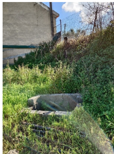
Sistema drenagem de águas pluviais existente
